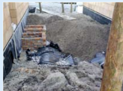
Żwirowy GWC umieszczony pod garażem
