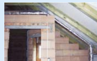
Przewody wentylacyjne na poddaszu
