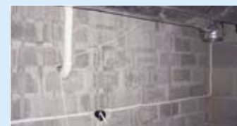
Czerpnia powietrza w ścianie piwnicy
