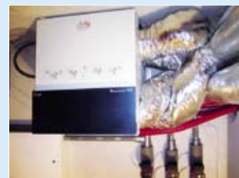
Rekuperator zamontowano w piwnicy, obok pompy ciepła
