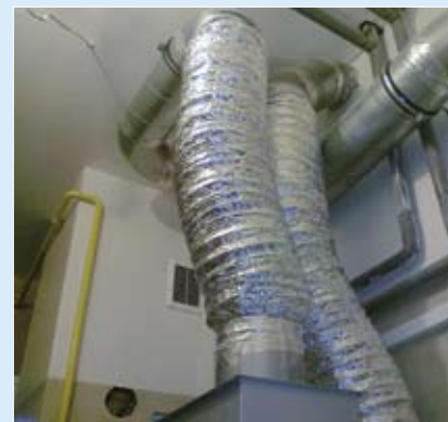
Tłumiki akustycznych, wygłuszające pracę centrali wentylacyjnej
