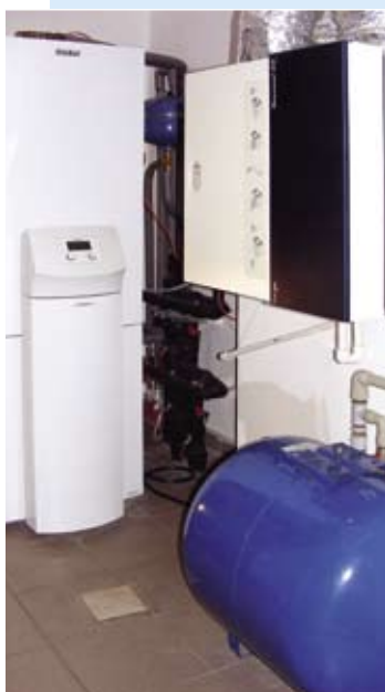
Rekuperator umieszczono w pomieszczeniu z pompą ciepła
